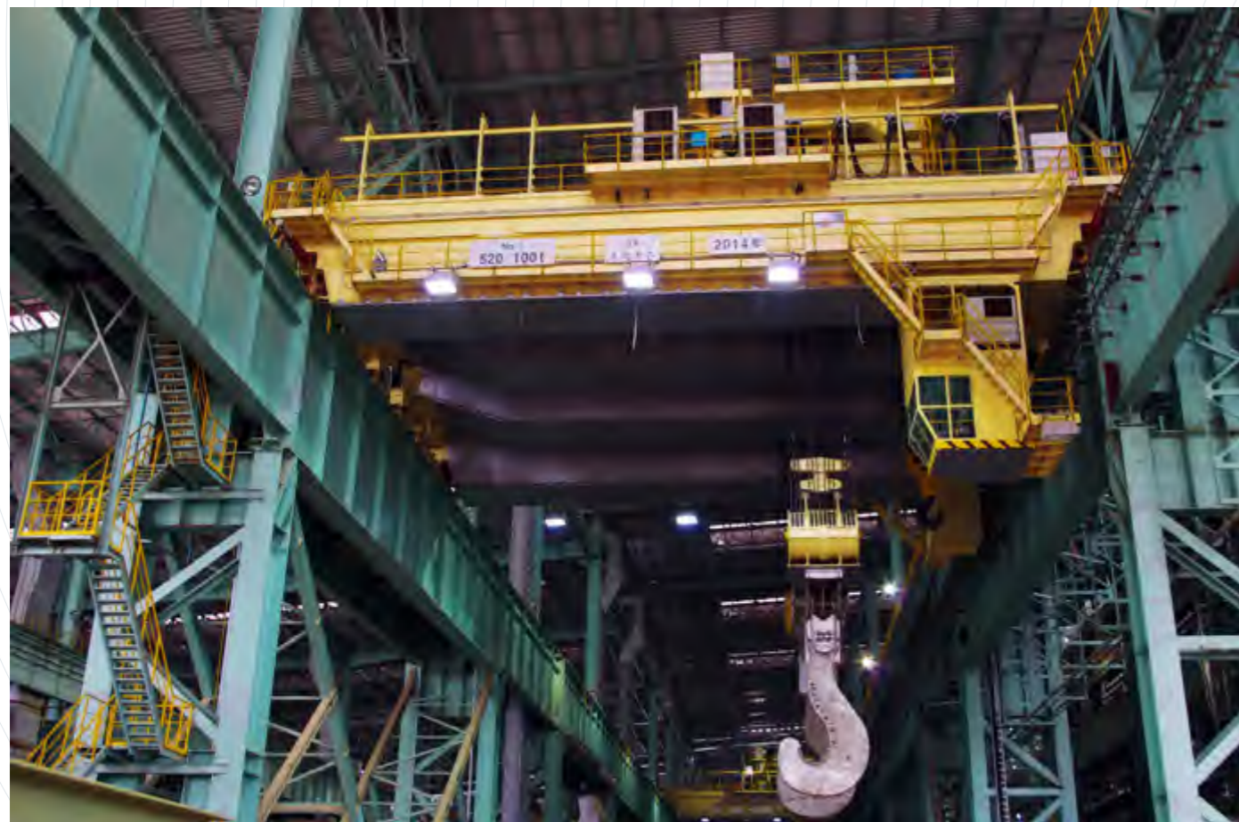
520t铸造起重机 520t Teeming Crane
