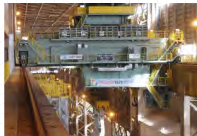
480t铸造起重机 480t ladle crane
